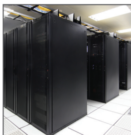
电信基础设施
